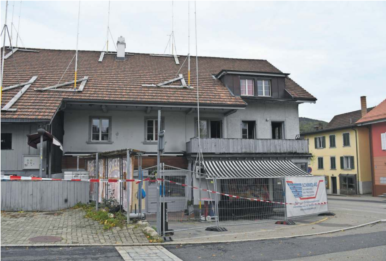
Die Liegenschaft an der Zürichstrasse in Affoltern gilt seit dem Brand am vergangenen Samstagmorgen als einsturzgefährdet. Das Areal wurde deshalb polizeilich abgesperrt. (Bild Livia Häberling)
