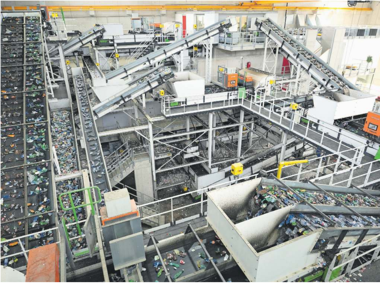
Förderbänder, so weit das Auge reicht. Da die Agir Aggregat im Anlagenbau tätig ist, war der Bau und Betrieb der PET-Sortieranlage naheliegend. (Bilder Martin Platter)
