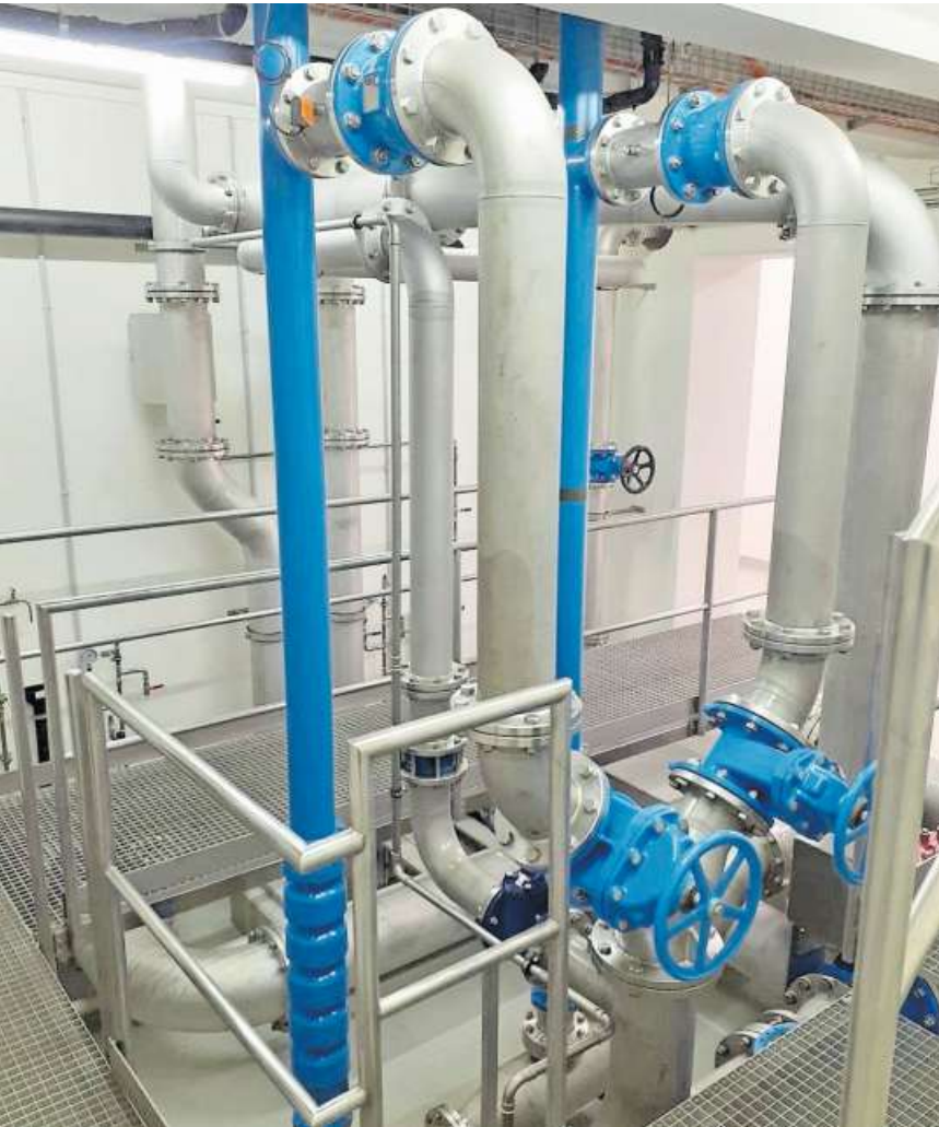
Blick ins Innere des Quellwasserpumpwerks Rinderweidhau bei Affoltern. Der Um- und Neubau wurde im Jahr 2021 fertiggestellt. (Bild zvg)
